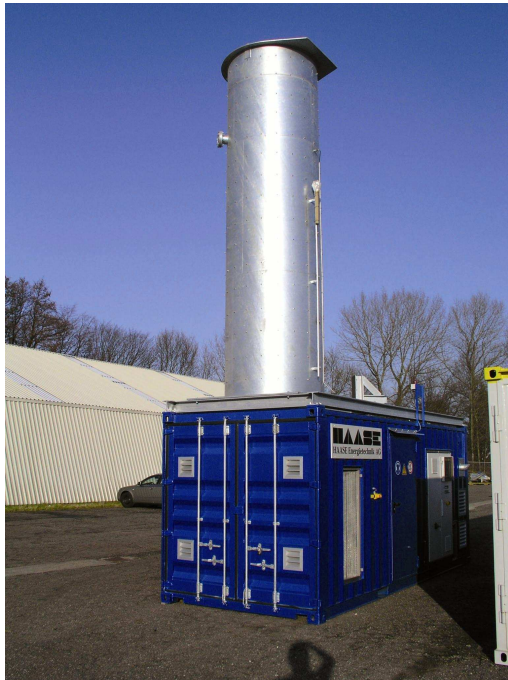
Bild 1 : Mobile Hochtemperaturfackel für die Entsorgung explosiver Gemische aus Tanklagern. Die Gesamtfeuerungsleistung liegt bei 5 MW mit einer Absaugleistung von 500 bis max. 3.000 m 3 /h.
