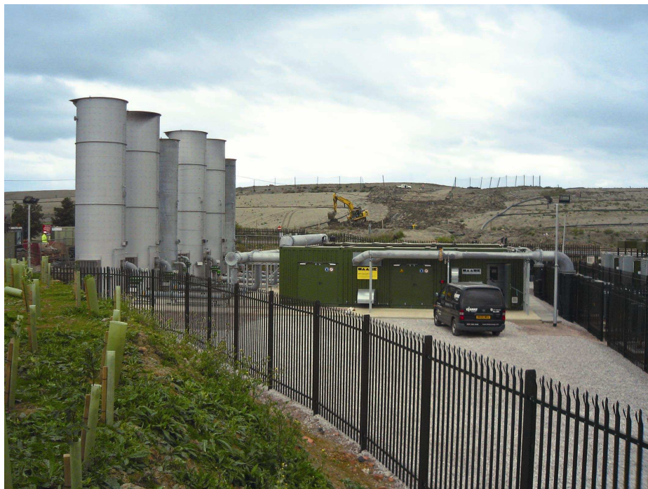
Bild 3 : 6 Deponiegasfackeln auf der Deponie Brogborough, England Gesamtfeuerungsleistung 100 MW. Die dazugehörigen HAASE Gasverdichterstationen fördern insg. 27.600 m 3 /h Deponiegas
