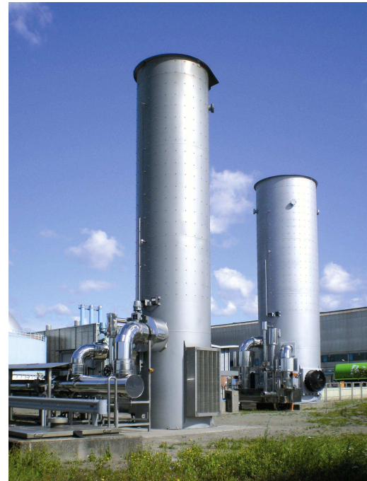
Bild 2: HAASE Klärgasfackeln Neben der bereits seit 2004 betriebenen Fackel (links, 12,5 MW) wurde 2007 eine weitere Fackel (rechts, 27 MW) installiert. Sie besitzt neben einem zweistufigen Brenner einen Pilotbrenner für Kleinmengen.
